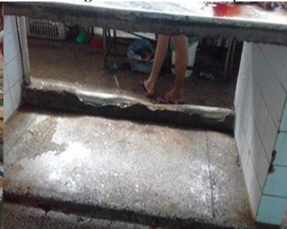
Figura 12 - Resíduos no piso.
